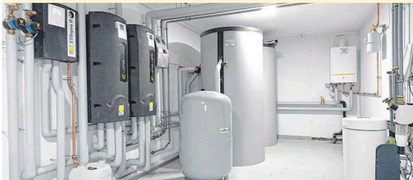
Moderne Heizungstechnik, eingebaut von Miehle & Noak.
